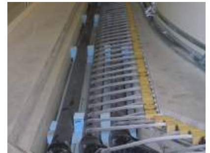
Jäähalli, rataputket yhdistyvät jakotukkeihin
